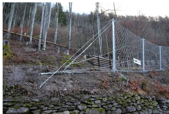
Netzende mit seitlichen und hinteren Abspannungen
